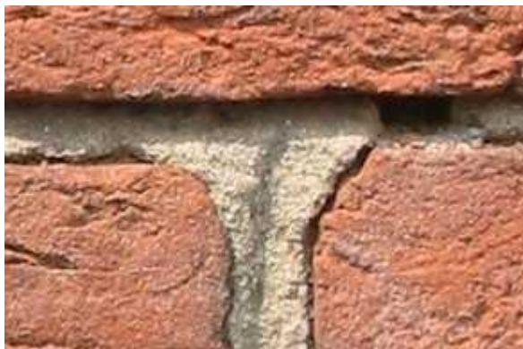
Mörtel: Hart, spröde, Trockenrisse
